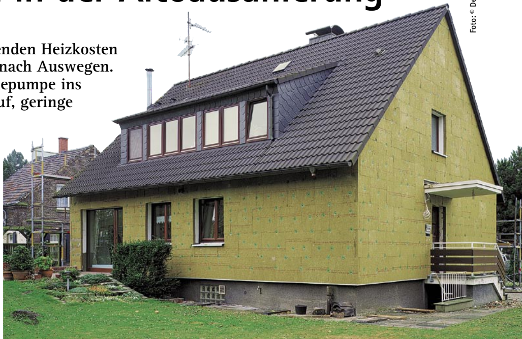
Der wirtschaftliche Einsatz von Wärmepumpen im Altbau erfordert ein energetisches Gesamtkonzept
